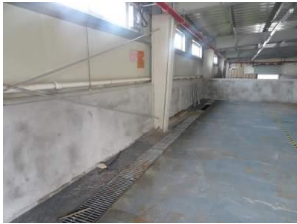
防腐防渗地面、导流沟（摄于危废仓库）
